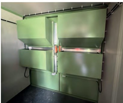
Zuluftöffnungen mit elektrischen Jalousienklappen serienmäßig
