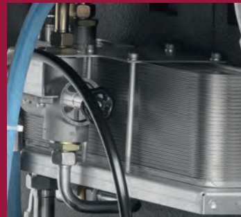
Wärmerückgewinnung zur Warmwasseraufbereitung
